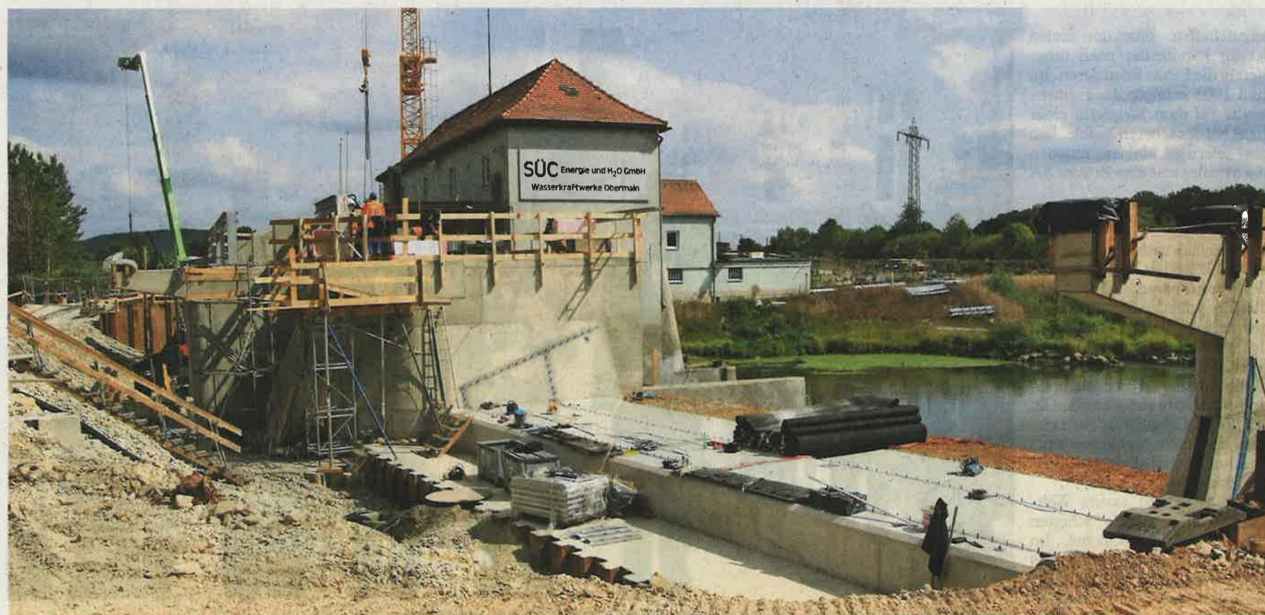
An der Schleuse in Hausen wird ein neues Schlauchwehr eingebaut. Der schwarze Schlauch, der in der Mitte liegt, wird später den Wasserstand regulieren.
