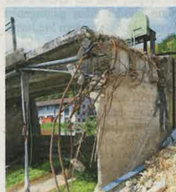
Der alte Beton war marode.
