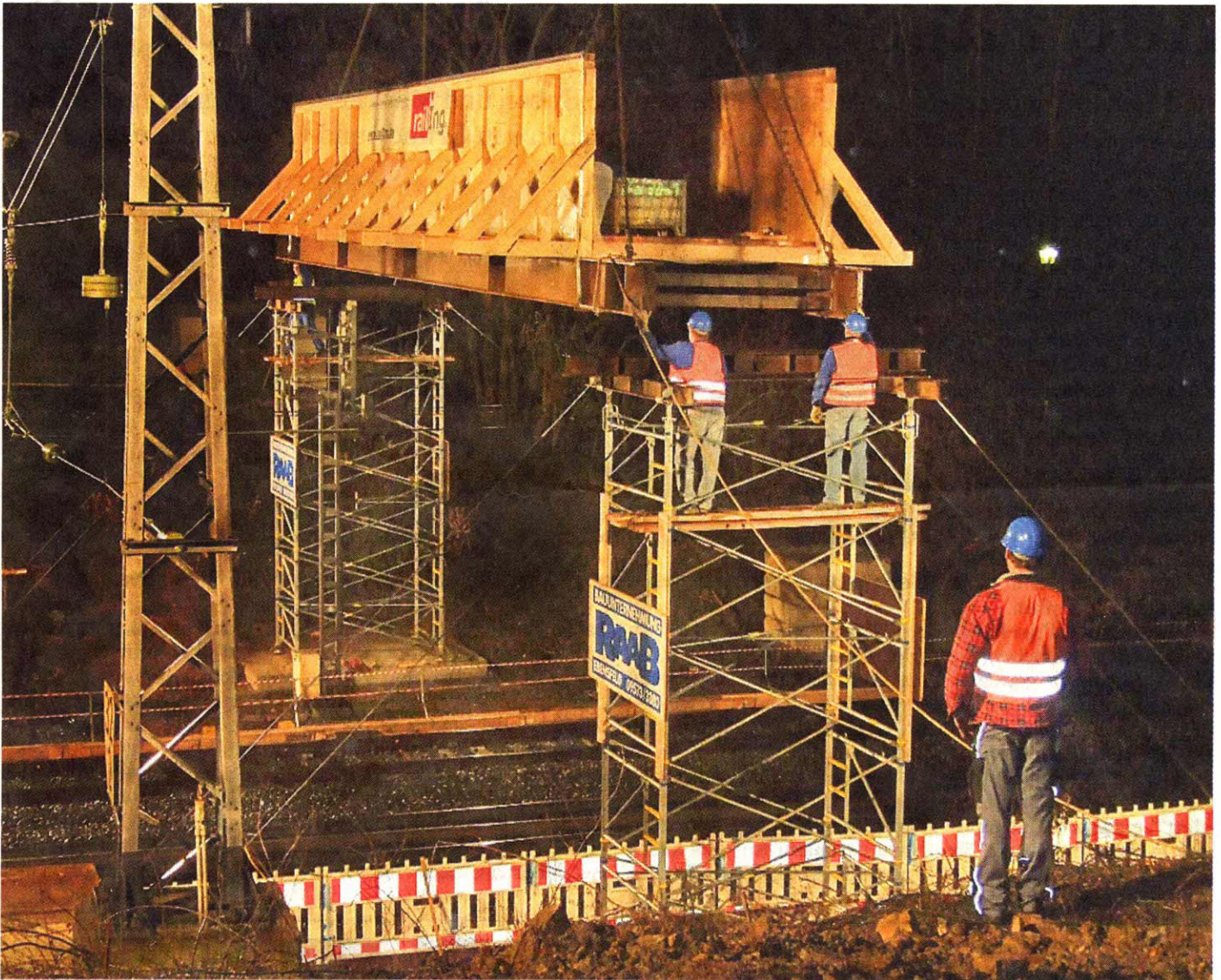
Das erste Teil der provisorischen Fußgängerbrücke über die Bahnlinie wird eingeschwenkt und auf die Stützen gesetzt. Die hellen Punkte sind nicht etwa Sterne oder Sternschnuppen, sondern Wassertropfen auf der Kameralinse.
