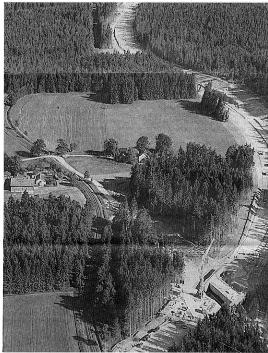
LOS 22 Schönwald der A 93, Blick nach Süden. Im Vordergrund ist die Unterführung der Bahnlinie zu sehen.
